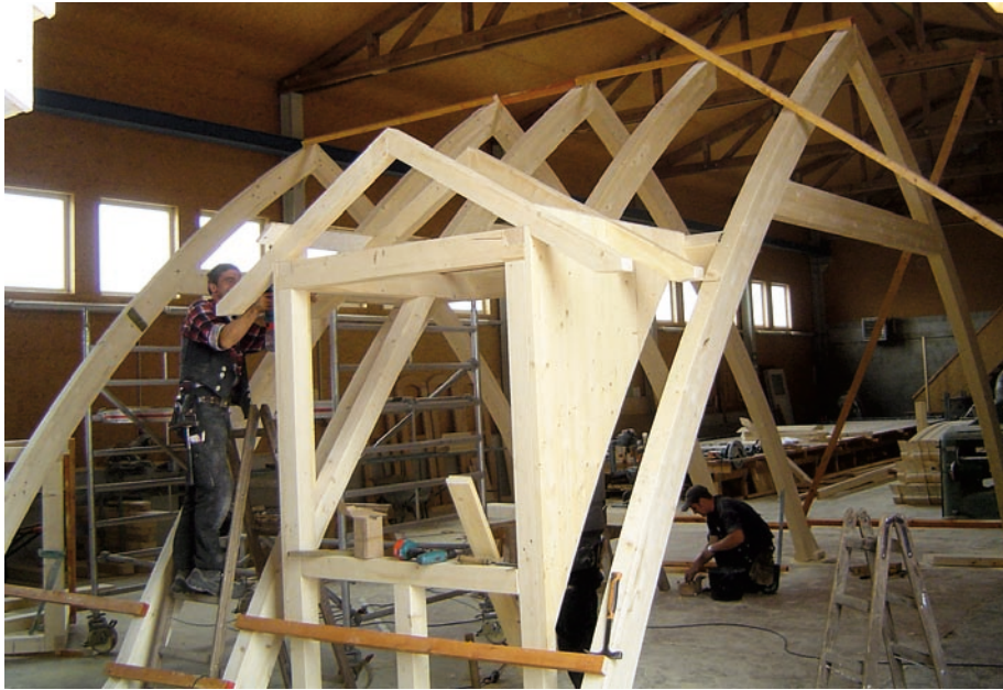
Die Gauben wurden in der Abbundhalle vorgefertigt und komplett auf die Baustelle geliefert.
